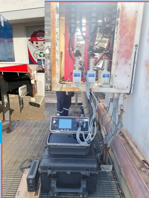
ANALISIS ELECTRICO DE MOTORES EN SITIO
