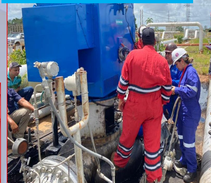
PRUEBAS DE ACEPTACION EN CAMPO
