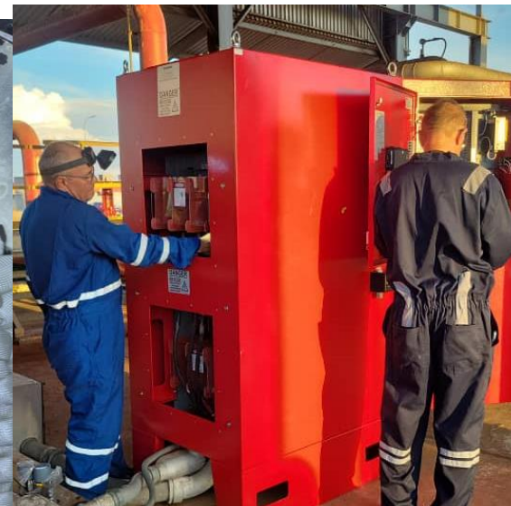
PUESTA EN MARCHA CONTROL DE SISTEMA CONTRA INCENDIOS
